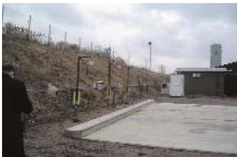
Фото 3. Компрессорная станция и заправочные посты газовых баллонов
