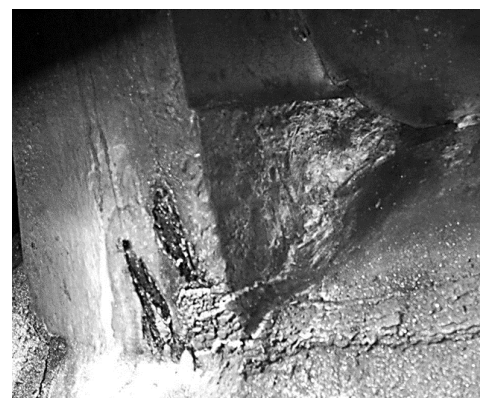
Рис. 1. Сварочный шов с трещиной.
