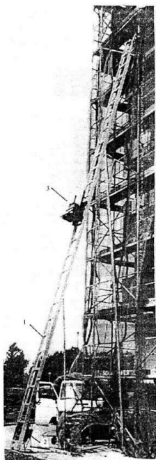
Рис. 2.Подъемник системы Lift (Германия) для подачи мелкоштучных материалов.
