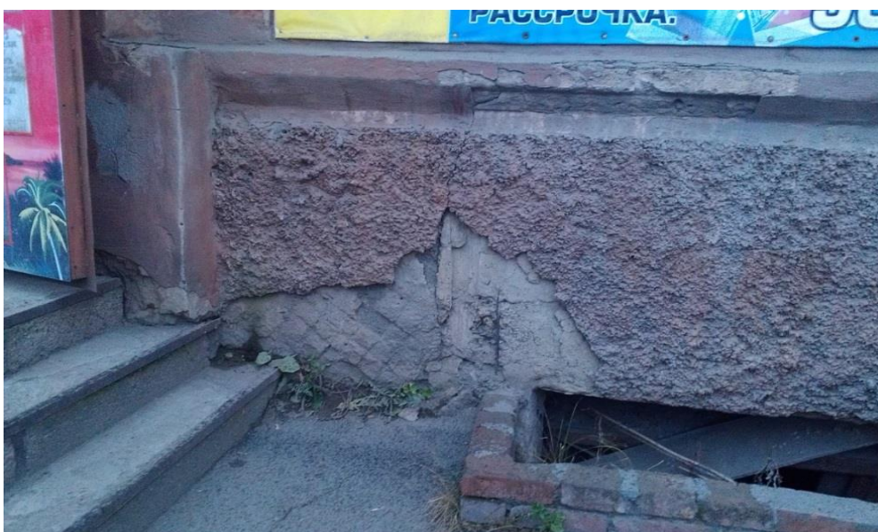
Рис. 9. Пример разрушения цоколя из-за неподготовленного основания
