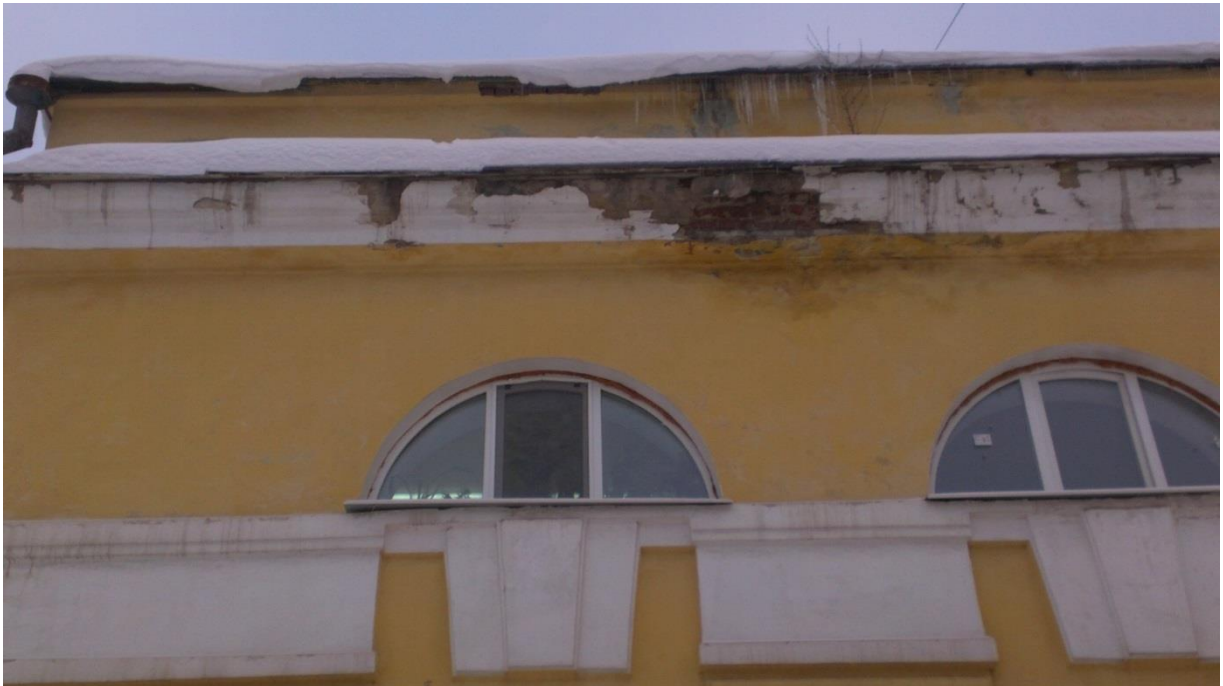
Рис.4. Разрушение фасада в результате неправильно устроенного карниза здания
