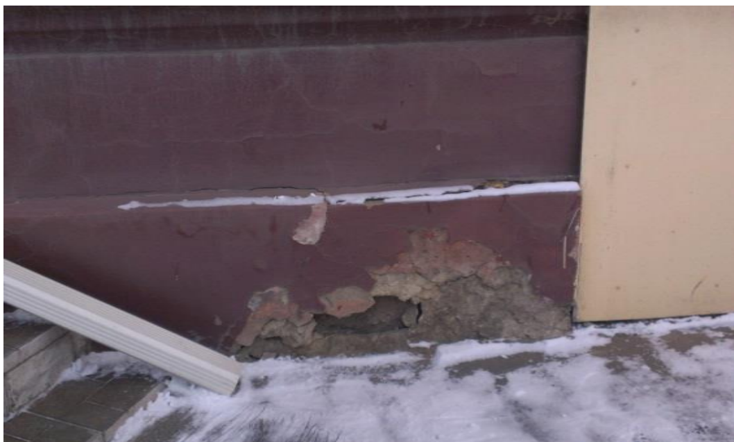
Рис.1. Разрушение цоколя из-за отсутствия отмостки
